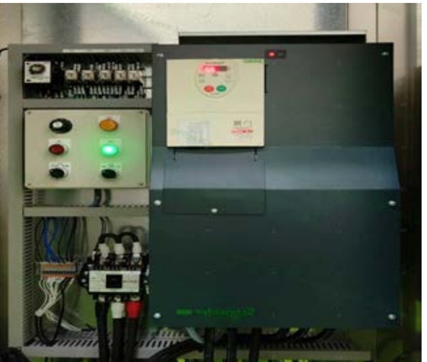
▲ 方案三 節能設備
