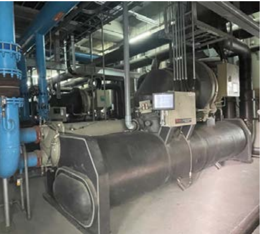
▲ 方案四 節能設備
